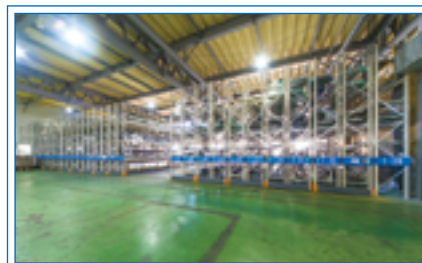
砺波工場 物流棟:移動ラックロケーションシステム
