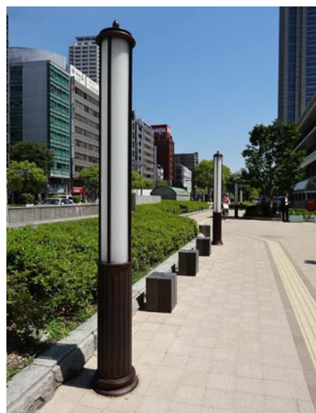
LED街路照明
