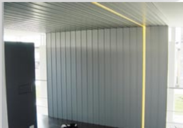
アルミリングを用いた輻射式冷暖房システム
