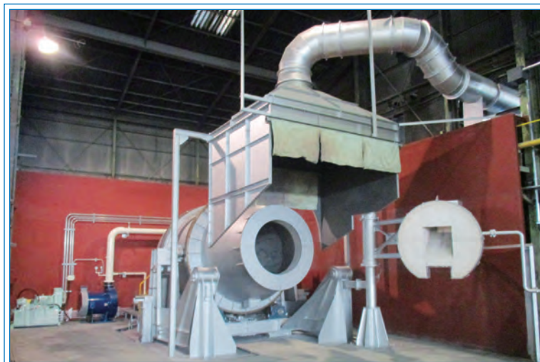
アルミリサイクル溶解設備
